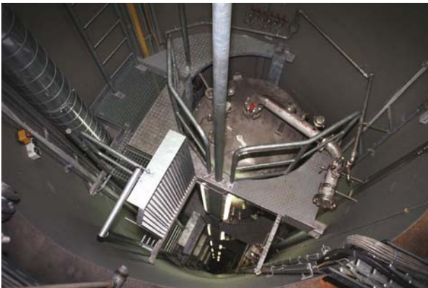
Safira - Pilotanlage zur Grundwassersanierung in der Region Bitterfeld, Blick in einen der fünf Schächte der SAFIRA-Pilotanlage
